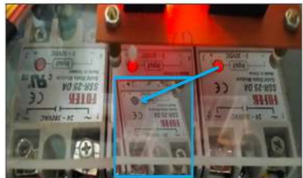
Gambar 60. Kondisi relay 3 pada saat OFF atau LOW kondisi 2
