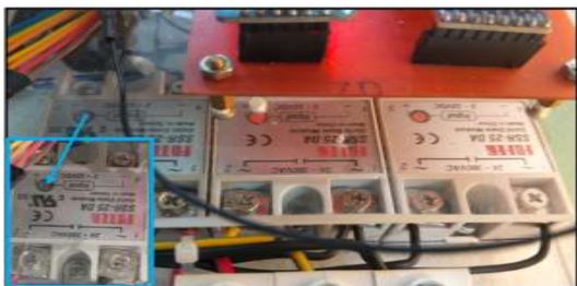
Gambar 50. Kondisi relay 1 pada saat OFF atau LOW kondisi 2
