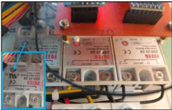
Gambar 35. Kondisi relay 1 pada saat OFF atau LOW kondisi 1
