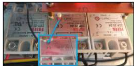
Gambar 40. Kondisi relay 2 pada saat OFF atau LOW kondisi 1
