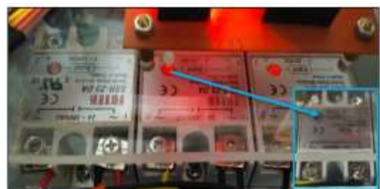
Gambar 55. Kondisi relay 2 pada saat OFF atau LOW kondisi 2
