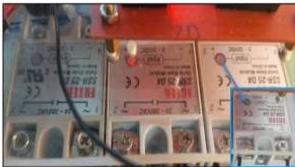
Gambar 45. Kondisi relay 3 pada saat OFF atau LOW kondisi 1
