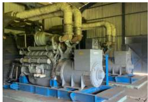
Gambar 1. Foto Generator Sinkron Pada PT. Cahaya Fajar Kaltim
