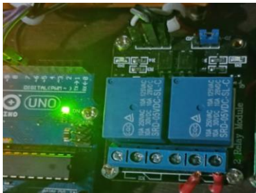
Gambar 13. Relay tidak bekerja
